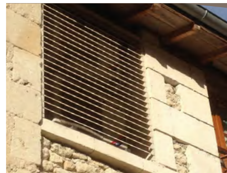
Exemple d'intégration réussie d'un aérotherme dans le bâti, masqué par une grille.
