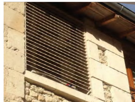
Exemple d'intégration réussie d'un aérotherme dans le bâti, masqué par une grille.
