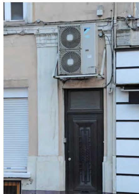
La fixation d'aérothermes ou "pompes à chaleur" en façade n'est pas compatible avec la préservation du patrimoine bâti et paysager dans le périmètre de l'AVAP.
