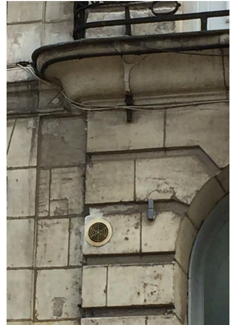
La bouche de ventilation dégrade le porche en pierre de cette façade Classique.
