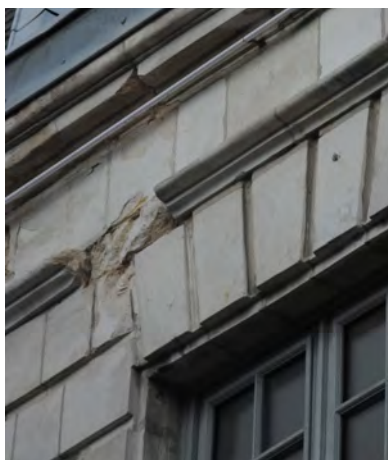
Un bandeau endommagé laisse le ruissellement d'eau pénétrer la façade et dégrader le parement. Une réparation de la pierre doit être effectuée pour restaurer la protection.
