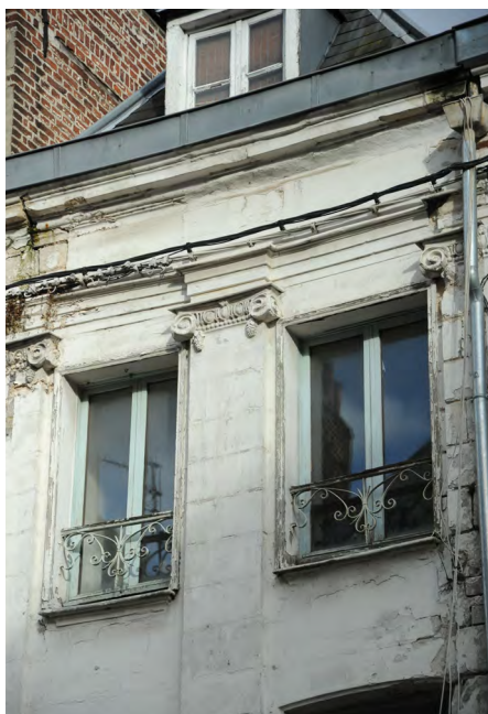
Cette façade modeste pourrait retrouver une belle prestance avec la restauration des moulures et le ravalement de la pierre.
