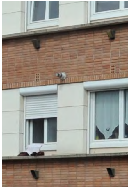
Ventouse de chaudière mal située dans une façade sur laquelle les anciens équipements avaient été placés régulièrement dans la trame.
