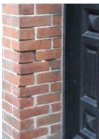
La disparition du joint fragilise la brique qui s'épauffre et se brise, en particulier dans les angles. Elle laisse l'eau imprégner la brique qui devient sensible au gel.
