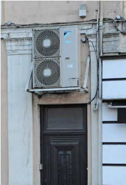
Pompe à chaleur installée au-dessus de la porte d'entrée d'un immeuble de style Classique.
