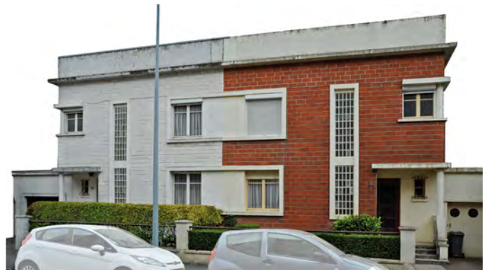
La mise en peinture générale de la façade a fait perdre la perception de la composition et des détails caractéristiques de cette architecture moderniste : cadre de baies, baies horizontales et verticales affirmées ; la façade est banalisée, et l'ensemble est déséquilibré.
