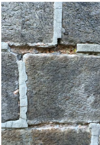
Un joint inapproprié, trop étanche, enferme l'humidité et finit par se dégrader.
