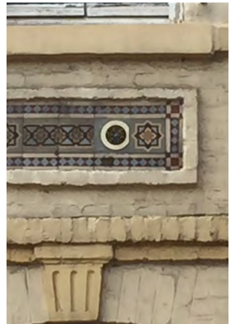
Frise de carreaux de ciment détruite.
