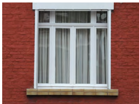
Appui de fenêtre recouvert de plaquettes, d'autant plus regrettable sous une menuiserie en bois d'origine, finement moulurée.
