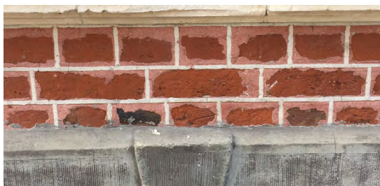
Briques endommagées par un rejointoiement inapproprié : les joints de brique, trop élargis par le dégarnissage de l'ancien mortier de jointoiement, ont été bourrés avec un mortier coloré, puis la ligne blanche a été ajoutée pour recréer visuellement un joint d'épaisseur normale.
