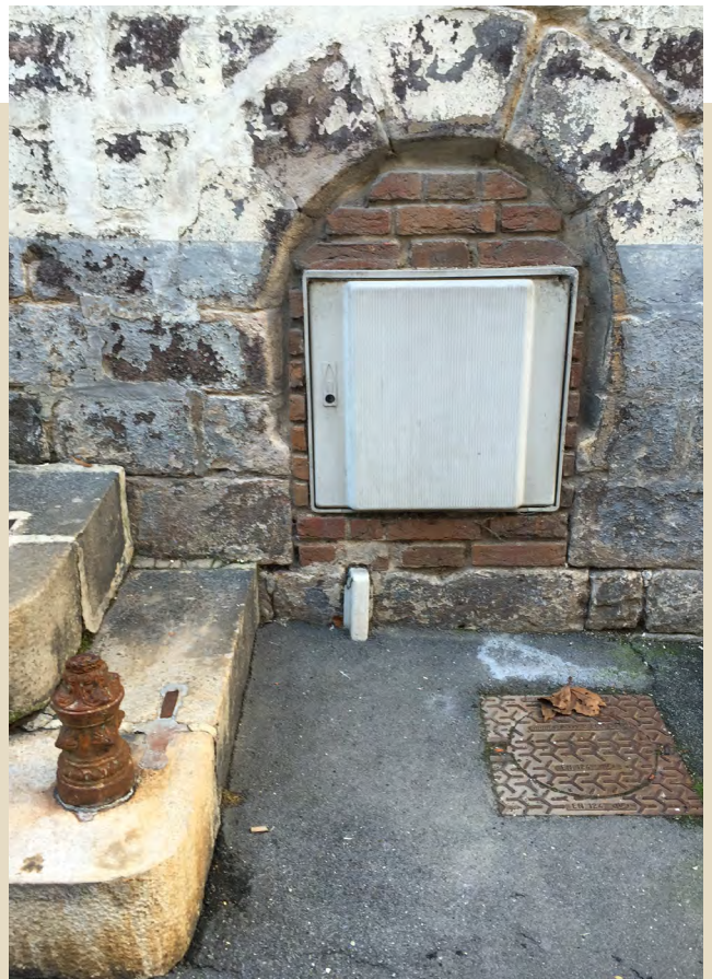
Coffret EDF encastré dans un ancien soupirail.
