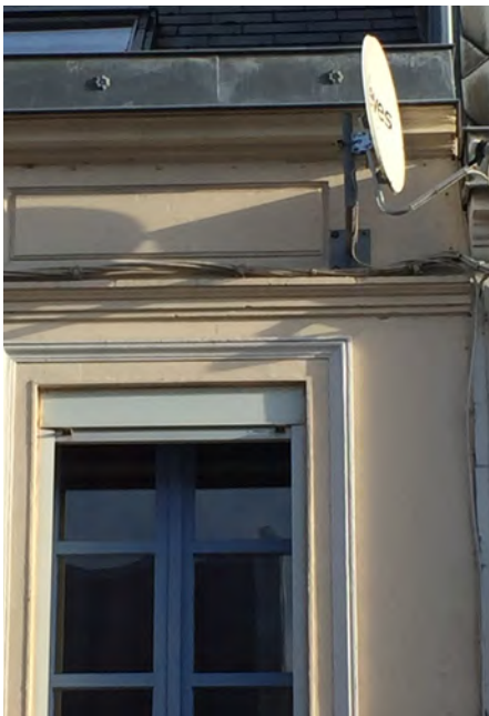
Parabole posée sur la façade.
