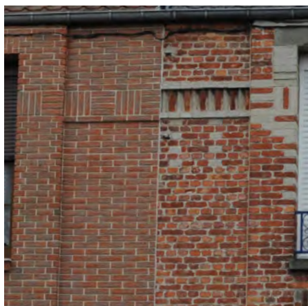
La brique a parfois été entièrement recouverte de plaquettes, lui faisant perdre toutes ses qualités. Lorsque la construction fait partie d'un ensemble de conception homogène, celui-ci est également est altéré.
