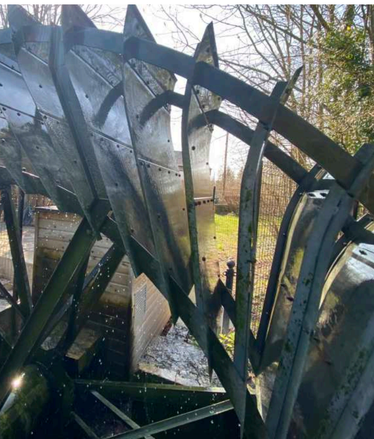
© CUA - installation hydro-électrique à Goeulzin
