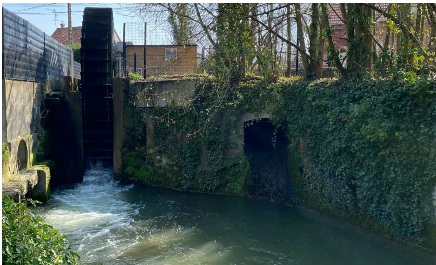
© CUA - installation hydro-électrique à Goeulzin
